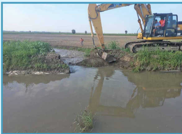
I lavori allo scolo Focchiera a Legnago, crollato nei giorni scorsi a causa dei danni provocati dalle nutrie. Sopra, a destra, un gruppo di questi grossi roditori
