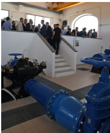
Nuove tecnologie Le pompe per immettere l'acqua in rete FOTO PECORA
