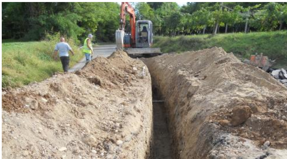
Uno dei cantieri del Consorzio di bonifica veronese nel territorio di Sona
