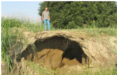
Frana sull'argine del Bussè causata dalle nutrie
