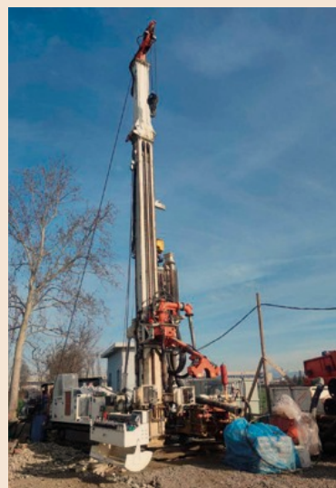
Intervento di recupero integrale del pozzo n.1 di Caravaggio (frazione Vidalengo) tramite il carotaggio continuo usando una perforatrice a circolazione inversa
